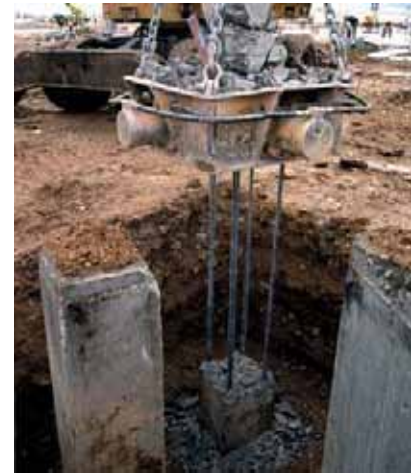
➔ Fotografía 5.- Pilote descabezado.
