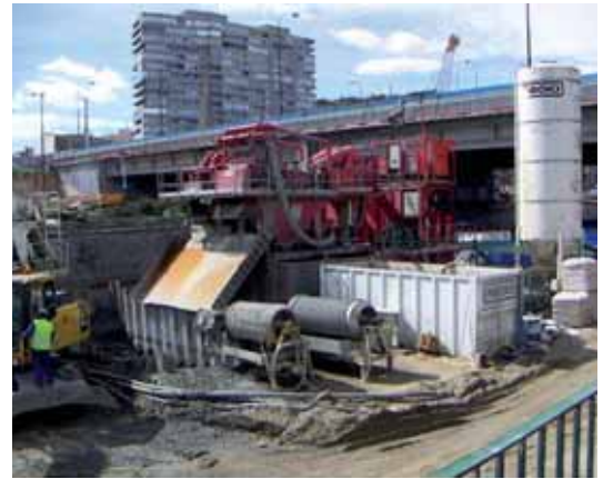
Fotografía 3.- Planta de lodos completa, río Manzanares.
