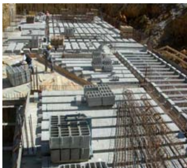
Figura 1.- Vista general de instalación del sistema de forjado: viguetas, bovedillas y zuncho perimetral. Foto: PRENOR.
