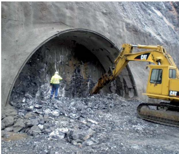
⇒ Figura 2.- Inicio de la excavación del túnel de Udalaiz en el tramo Mondragón-Elorrio.
